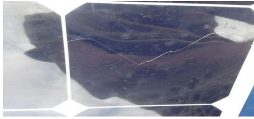
Figure 2-7: fissures dans les cellules PV
