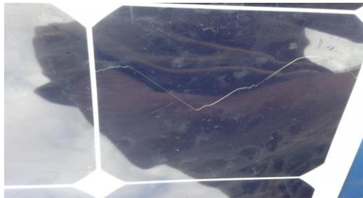
fissures dans les cellules PV
