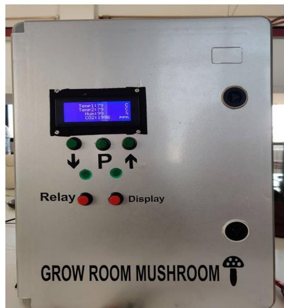
Figure III.32: l'affichage technique sur le panneau de commande
