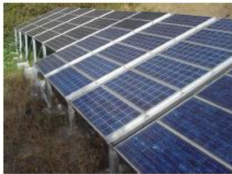
Figure III.13 : Panneau solaire photovoltaïque.
