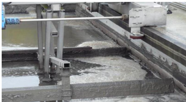
Fig. 02 : Désuilage (Station de Bordj Bou Arreridj : Mars 2017).
