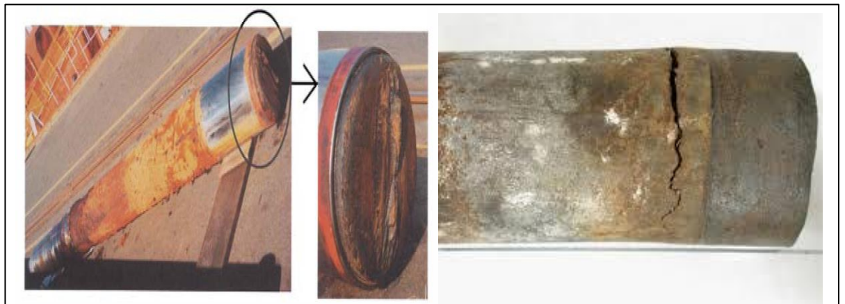
Figure (I.14) : Exemples sur la corrosion fatigue.
