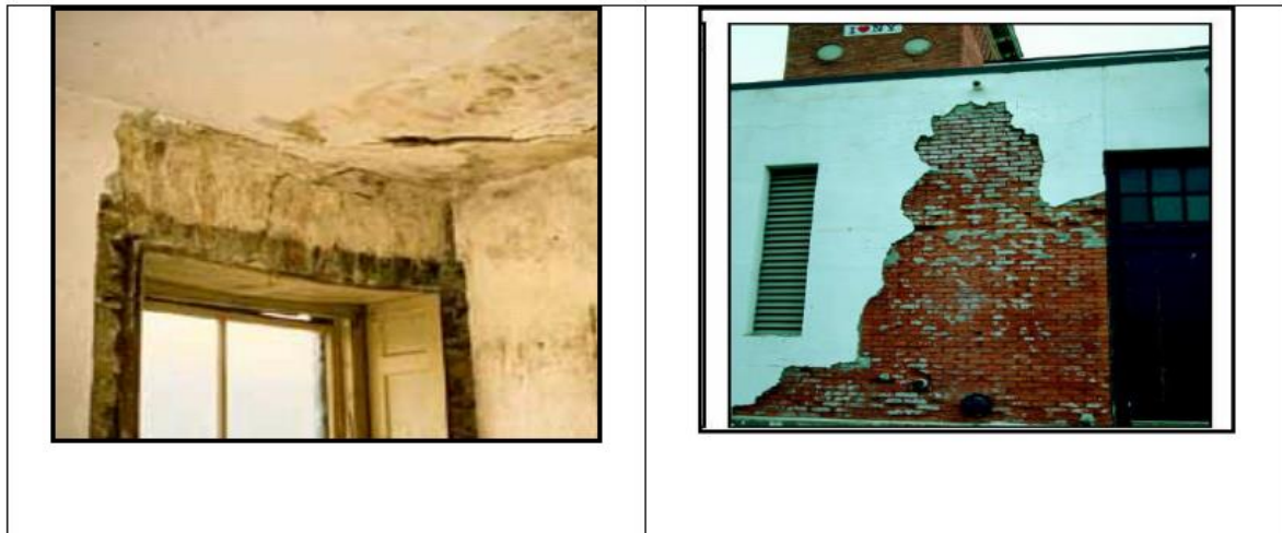
Figure I.6 :Deteration de lenveloppe inferieure dun batiment par leffet dhumudite ambiant[16]
