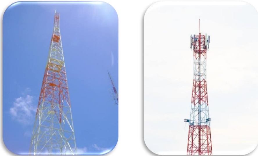
Fig I.62: Les pylônes à quatre pieds
