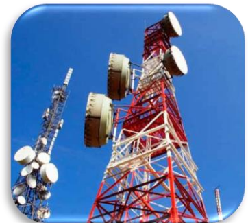
Fig I.2: Pylônes de télécommunication
