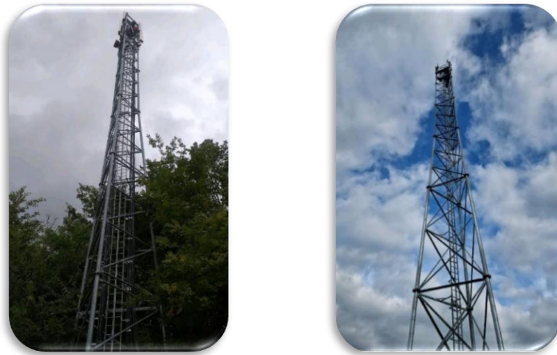
Fig I.59: Les pylônes à trois pieds
