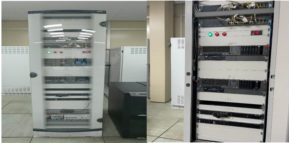
Figure 2. 6 : MTU dans la salle de contrôle.
