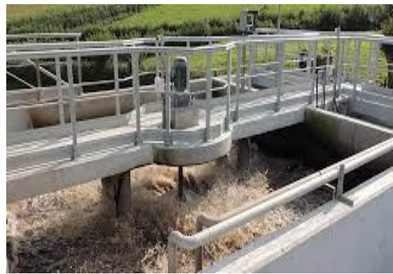
Figure I.6 : Aération dans un bassin biologique
