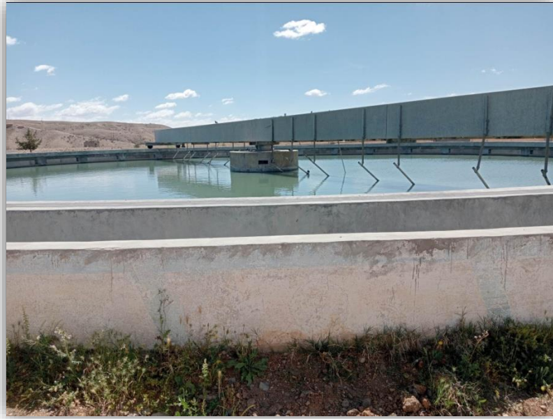
Figure II-7 : Station de décantation
