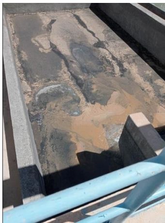
Figure II-8 : Bassin de filtration
