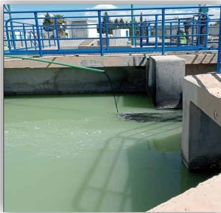
Figure II-6 : Injection de charbon actif
