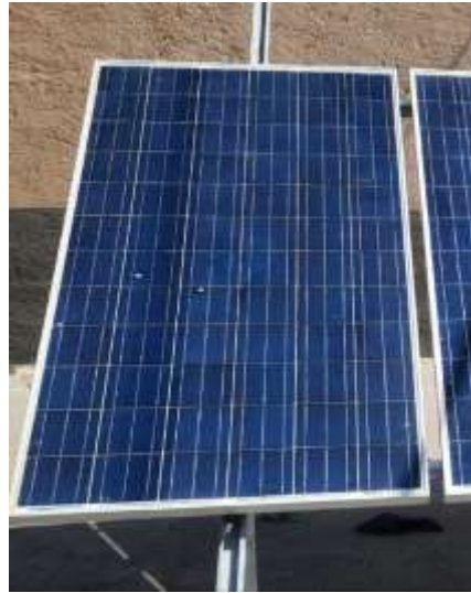
Figure II.25 Panneau solaire après nettoyage
