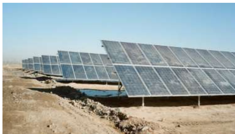
Figure II.19: Centrale solaire poussiéreuse
