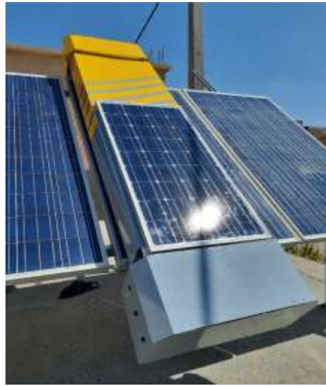
Figure II.48: Photo de l'appareil réel installé sur les panneaux
