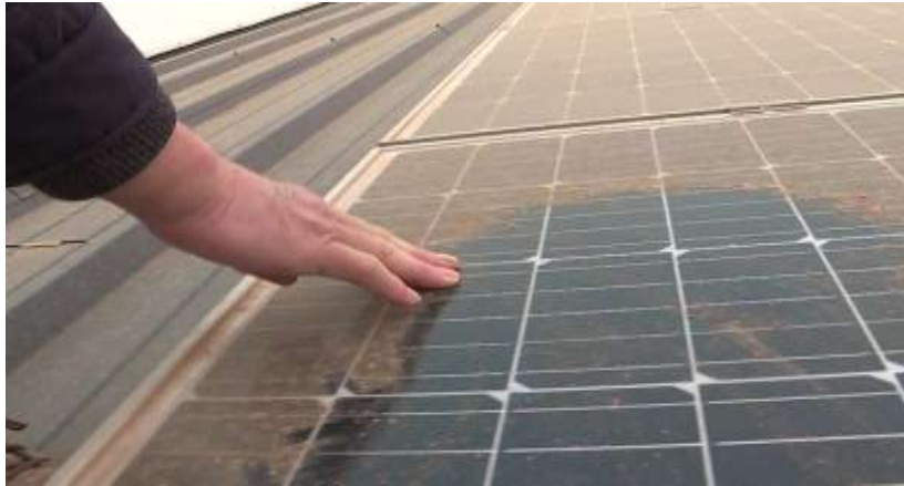
Figure II.18: Panneaux solaire poussiéreux
