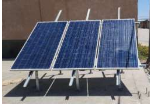
Figure II.46: Les panneaux solaires installés
