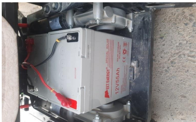
Figure .II.4. Photo réelle d'une batterie de capacité 12V.
