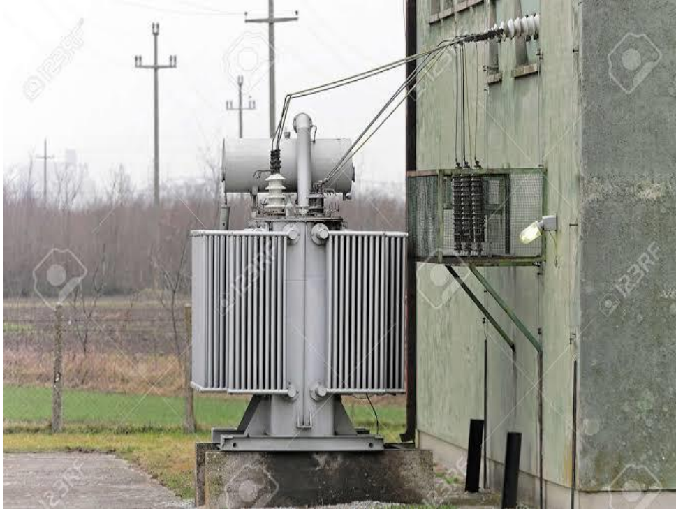
Figure1.3 : Transformateurs abaisseur de tension du système d'alimentation AC
