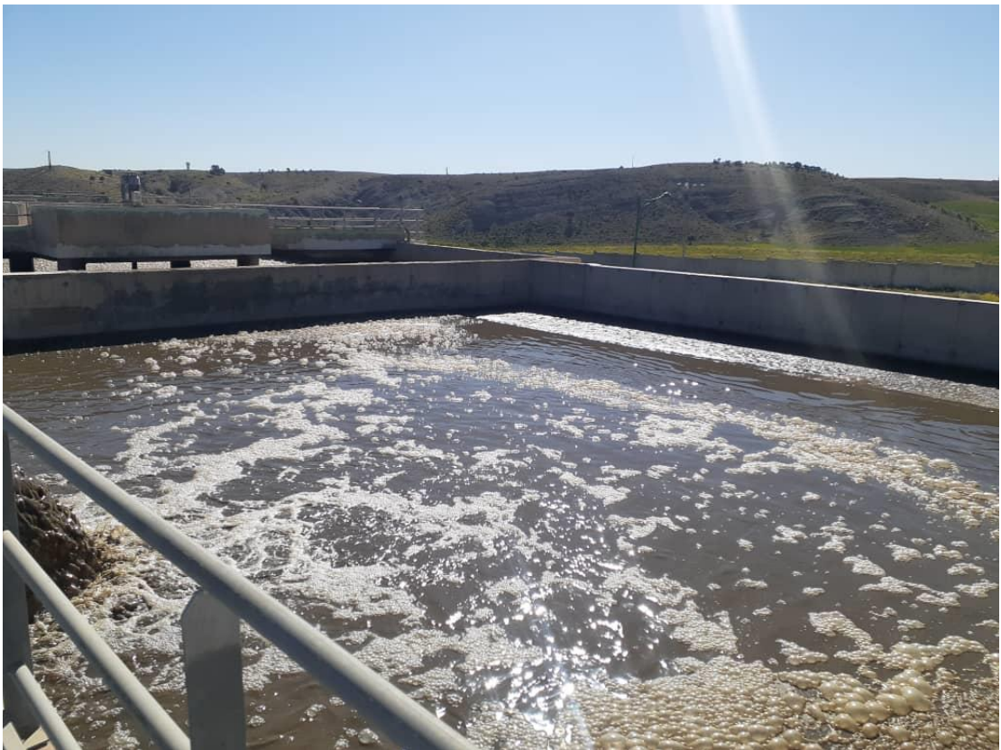
Figure II.3 : Bassin d'aération de STEP de Ain Taghrout.
