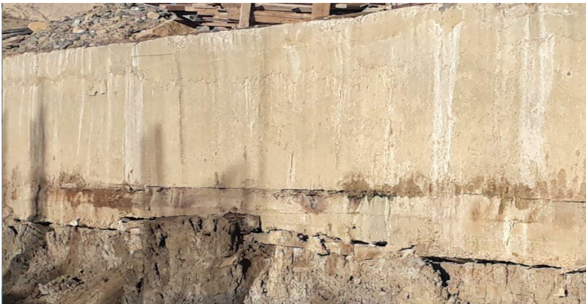
Figure I.4- Fissuration importante dans la base de canal existant.
