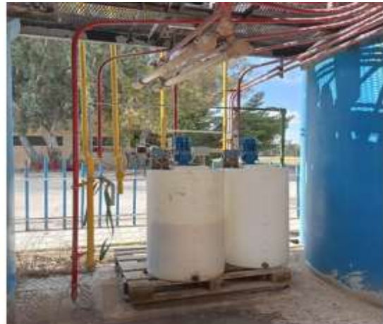
Pompes doseuses du coagulant/flocculant
