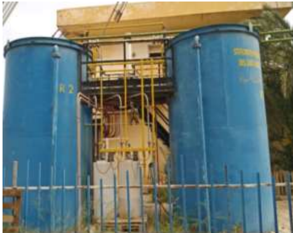
Cuves R1 et R2 de la station
