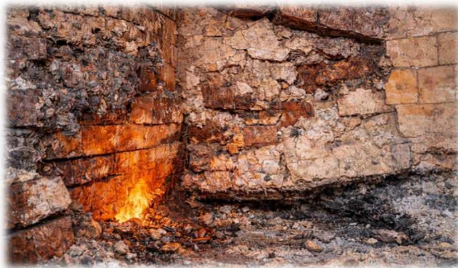
Figure I.14 : Dégradation d'un revêtement réfractaire sous l'effet des contraintes thermiques et chimiques
