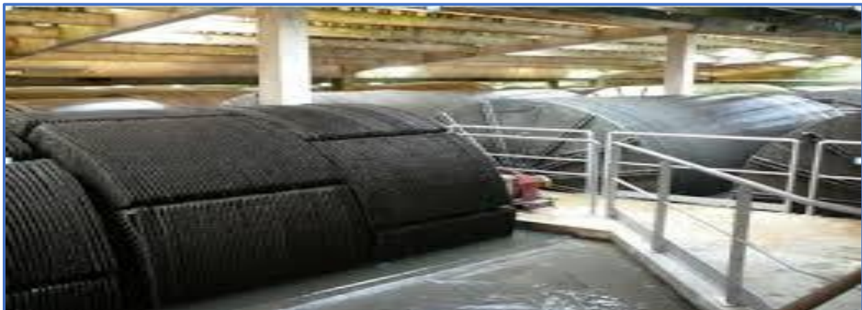
FIGURE 4: UNITES DE TRAITEMENT PAR DISQUES BIOLOGIQUES ; CREDIT PHOTO : PATRICK SAVARY (BERNARD CHOCAT, 2024).
