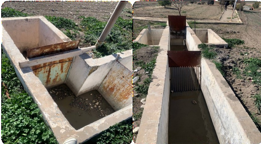
Figure 4étape de purification de l'eau saleté solide
