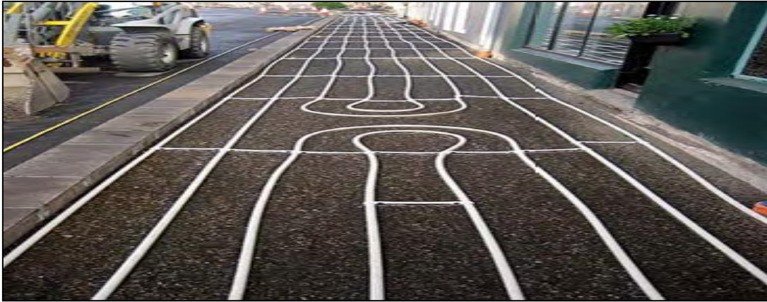
Figure(III.5). La circulation de l'eau chaude qui assure le déneigement des trottoirs [29].
