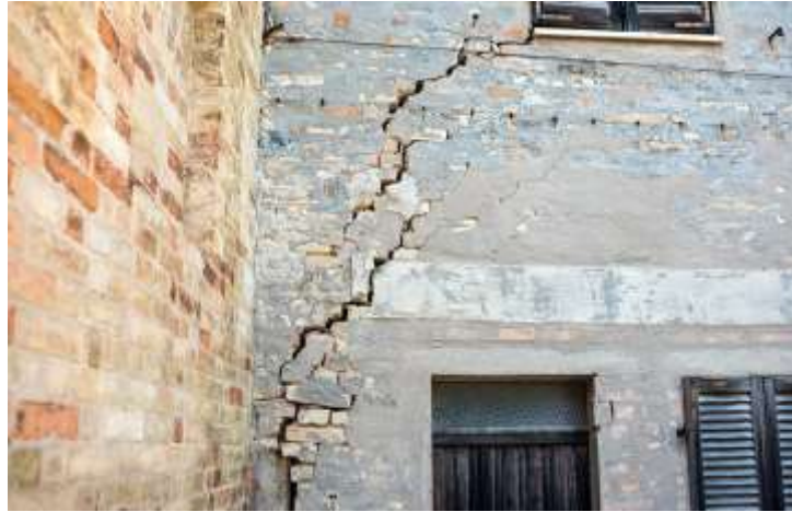
Figure I-1 Dommages structurels causés par un séisme
