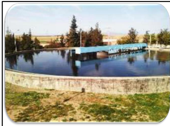
Figure III.7 : Décanteur secondaire (STEP BBA)
