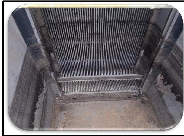
Figure III.2 : Dégrilleurs (STEP BBA)
