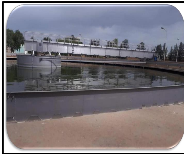
Figure III.5 : Décanteur primaire (STEP BBA).
