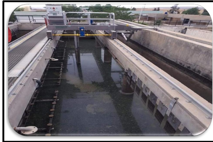
Figure III.3 : Déshuileur et dégraisseur (STEP BBA)
