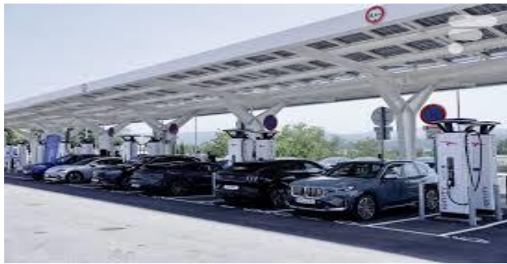
Figure 1.19 : Exemple des stations de recharge pour VE. [45]
