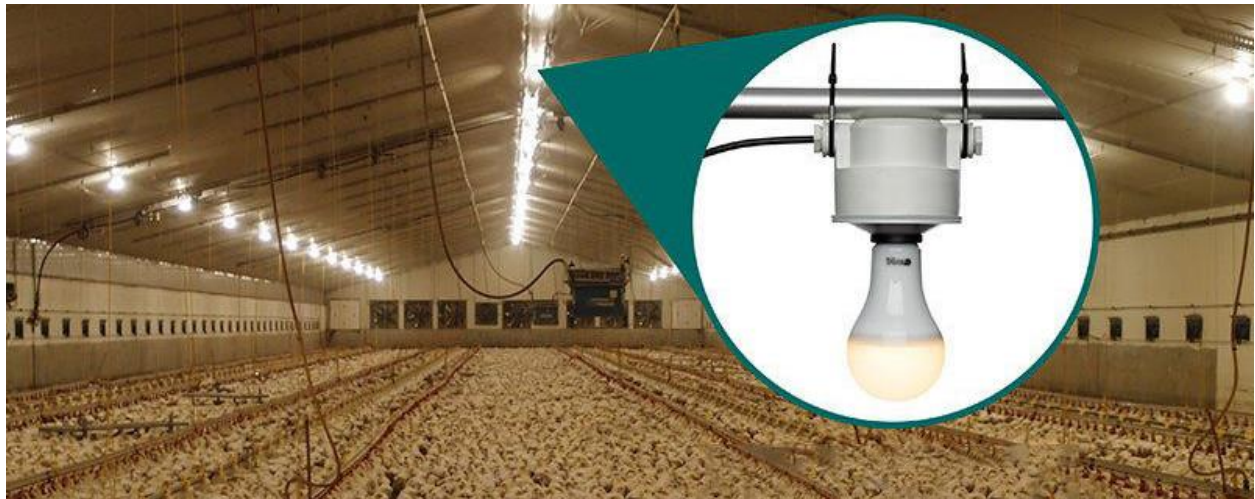
Figure I.10 : Lampes d'éclairage et de chauffage pour les volailles [19].
