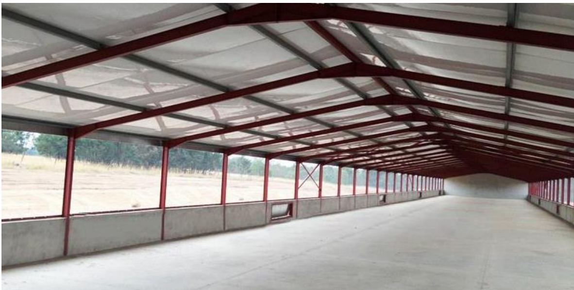
Figure I.1 : Exemple d'un bâtiment avicole clair avec ventilation naturelle [11].
