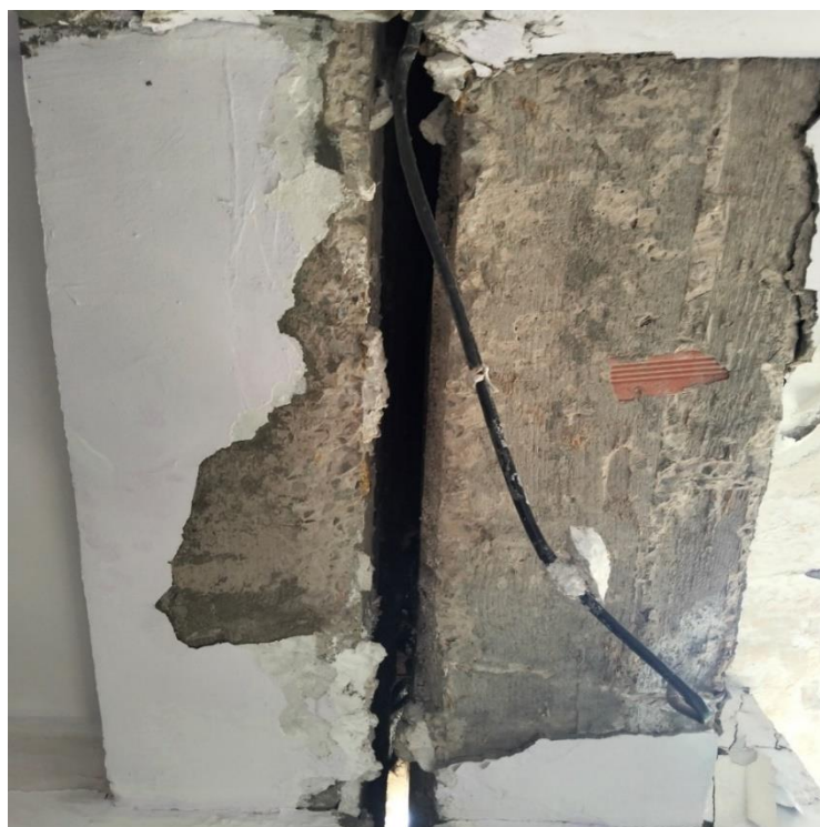
Figure I.7 : Ouverture du joint entre éléments structuraux de 10 cm.
