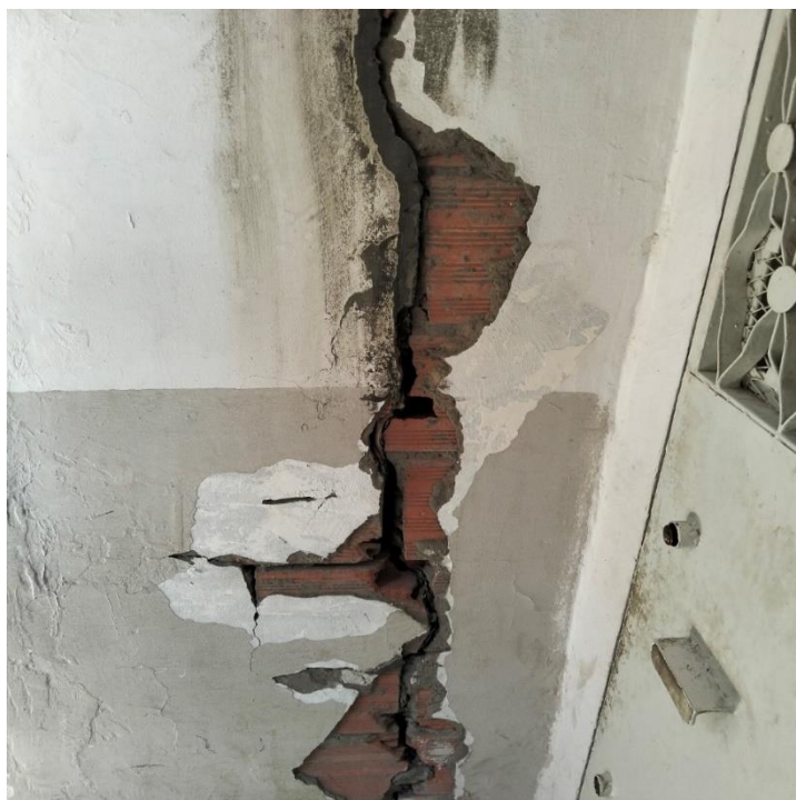
Figure I.8 : Eclatement du mortier et apparition des fissures au niveau du mur en maçonnerie.
