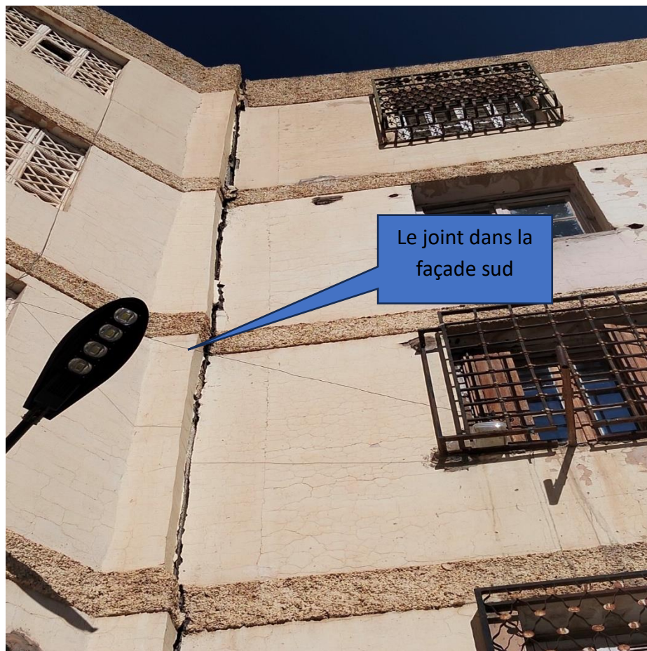
Figure I.6 : Propagation d'une fissure verticale au niveau de la façade Sud du bâtiment.
