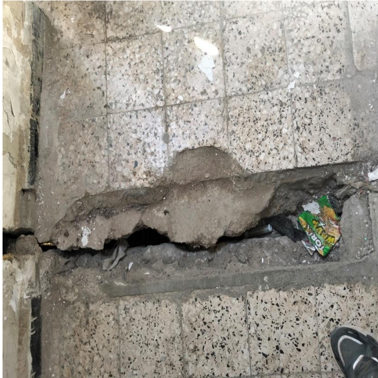
Figure I.10 : Eclatement de la dalle au niveau de 4eme étage
