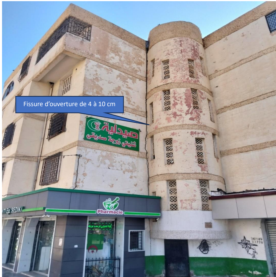
Figure I.4 : Façade Est du bâtiment concerné, fissure verticale entre la cage d'escalier et le reste du bloc.
