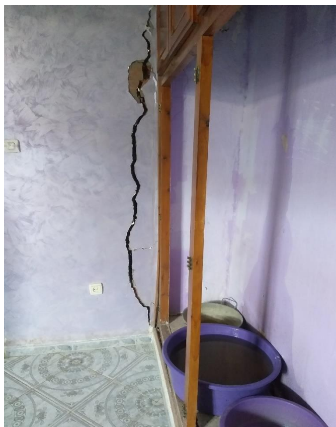
Figure I.9 : Fissure traversante de 6 à 8 mm évolutive dans le mur intérieur de la chambre du 4eme étage.
