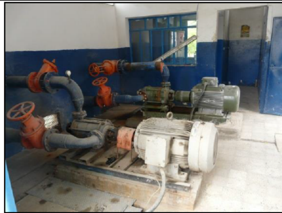
FIGURE 1.5 – exemple des pompes dans la station [13]
