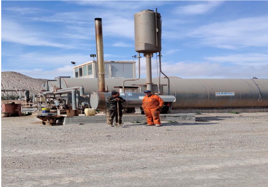
Photo.II.2. Citerne de stockage de bitume
