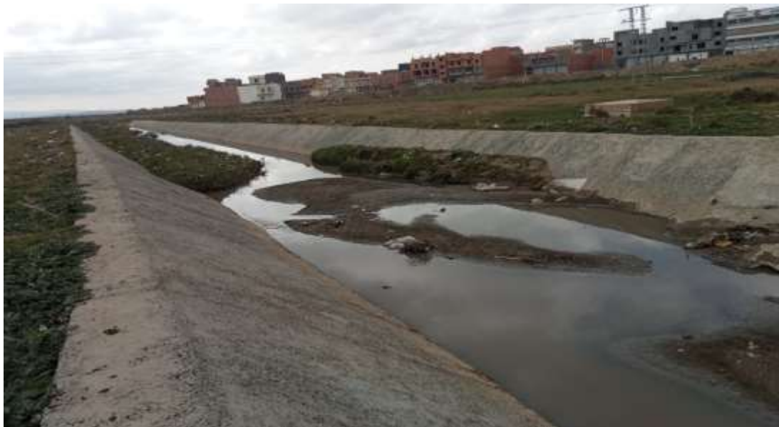
Figure II.4- Image d'ancienne protection pour l'oued Boumergued (existants actuellement)
