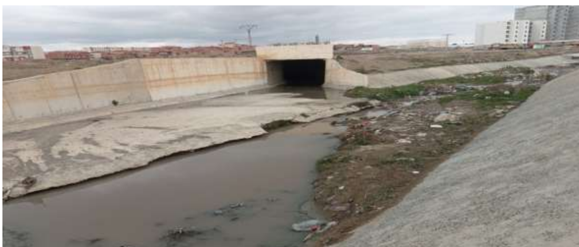
Figure II.5- Point de raccordement entre oued Boumergued (trapézoïdal à ciel ouvert) et oued Mardj El
