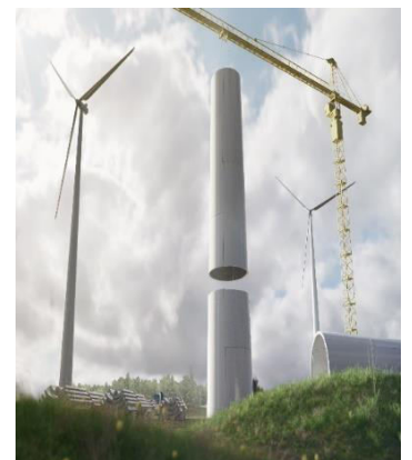
Figure II.6: Le mât de l'éolienne
