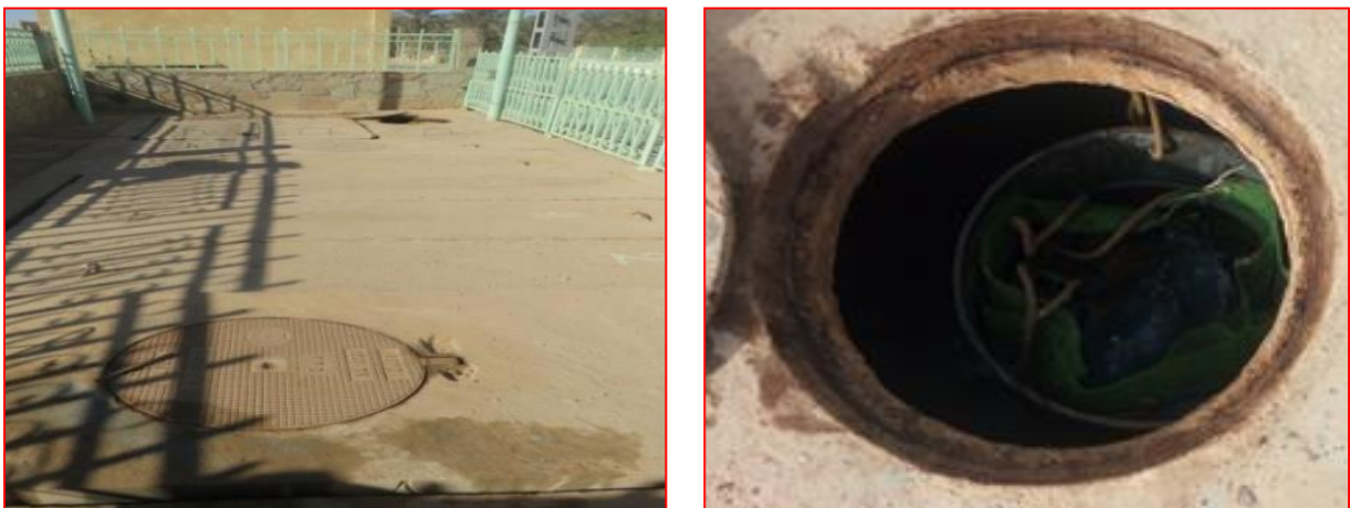
Figure 06 : Fosse septique de la WWG de Temacine
