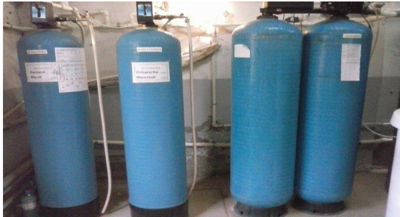
Figure n° 05: La ligne du traitement d'eau destinée à la fabrication
