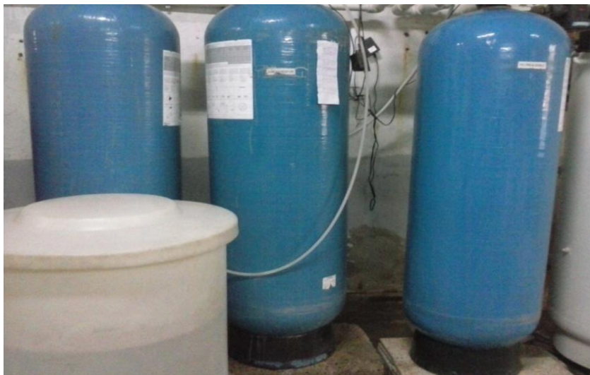
Figure n° 04: la première ligne du traitement d'eau de séchage
