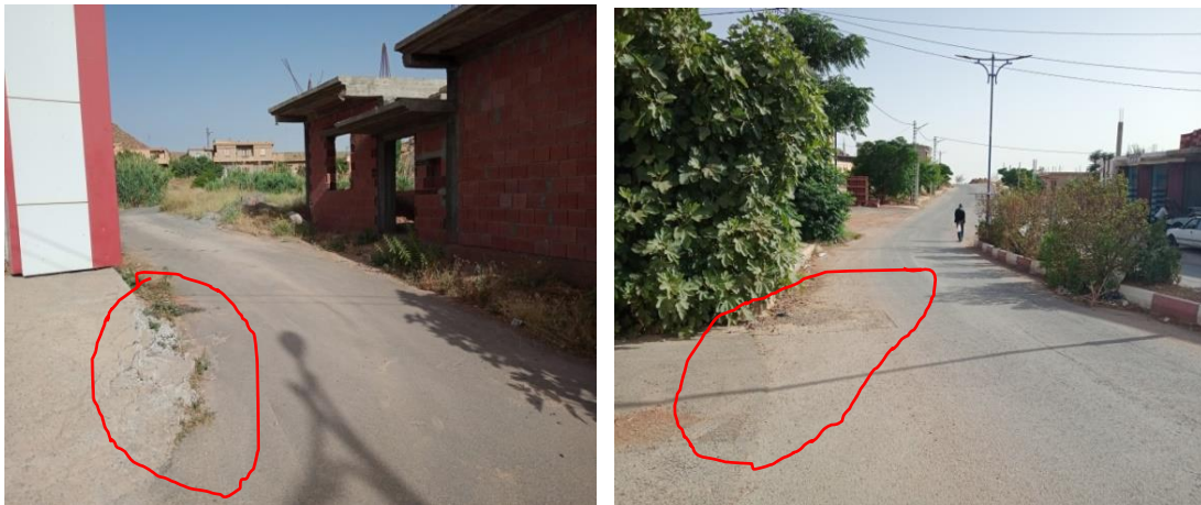
Figure.1. dégradation au niveau de la route
