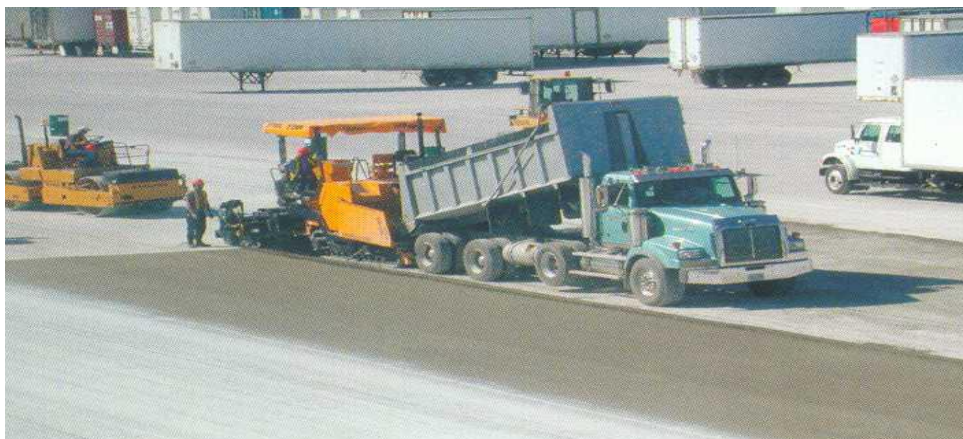
Figure I. 13: Transport, mise en place et mûrissement du BCR (American Concrete Pavement Association).
