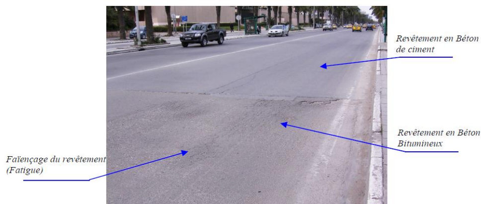
Figure I. 5: Déformations des revêtements rigides et souple - Avenue Mohamed V - Tunisie.
