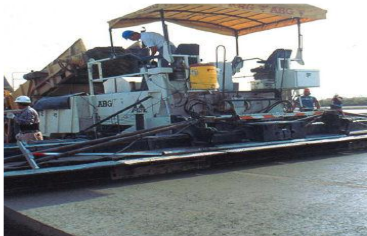
Figure I. 12: Mise en place du BCR par finisseur à haut pour de compactage (Association Canadienne du ciment).
