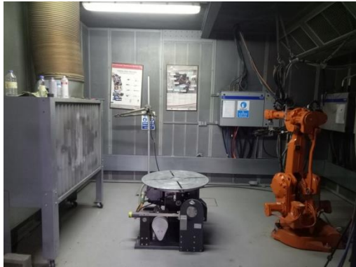
La chambre de la projection thermique
