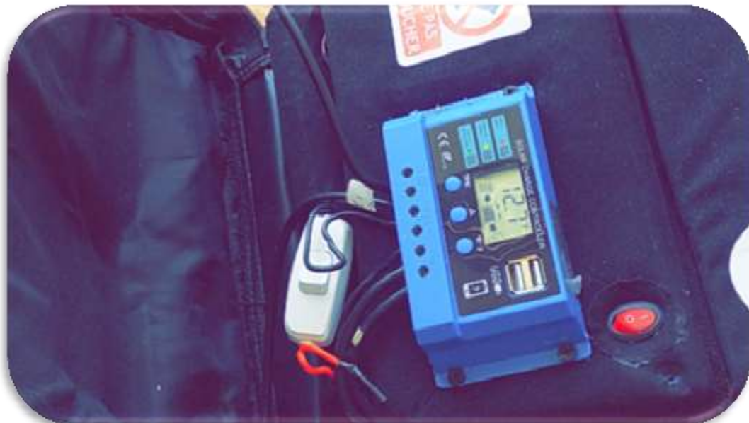
Figure III.24 : Fonctionnalité des panneaux solaires et du système de charge
