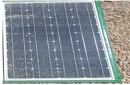
FigureI.5: Panneau solaire en état poussiéreux
