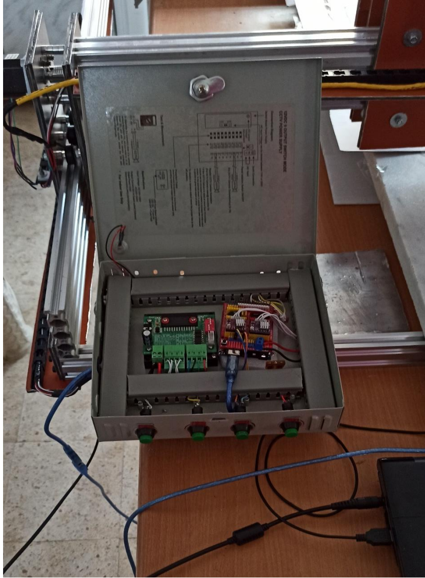
صورة 10.6. خزانة كهربائية.
