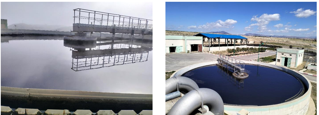
Figure 13 : Bassin de clarification
