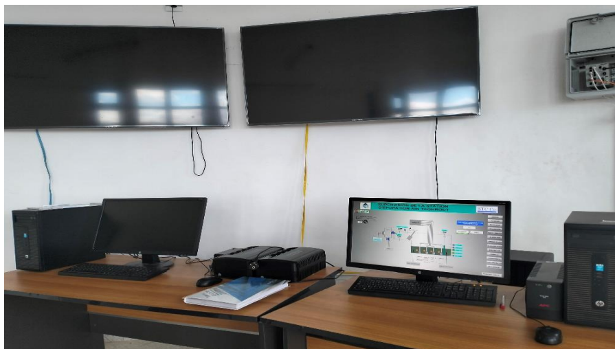
Figure 20 : Salle de contrôle
