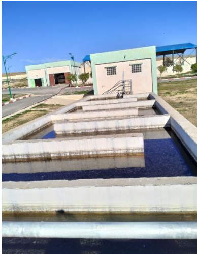
Figure 14 : Bassin de chloration
