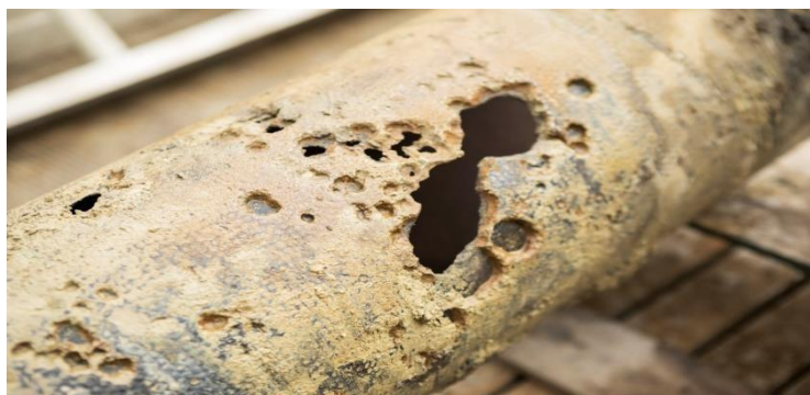
Figure II-8 : corrosion par O 2
