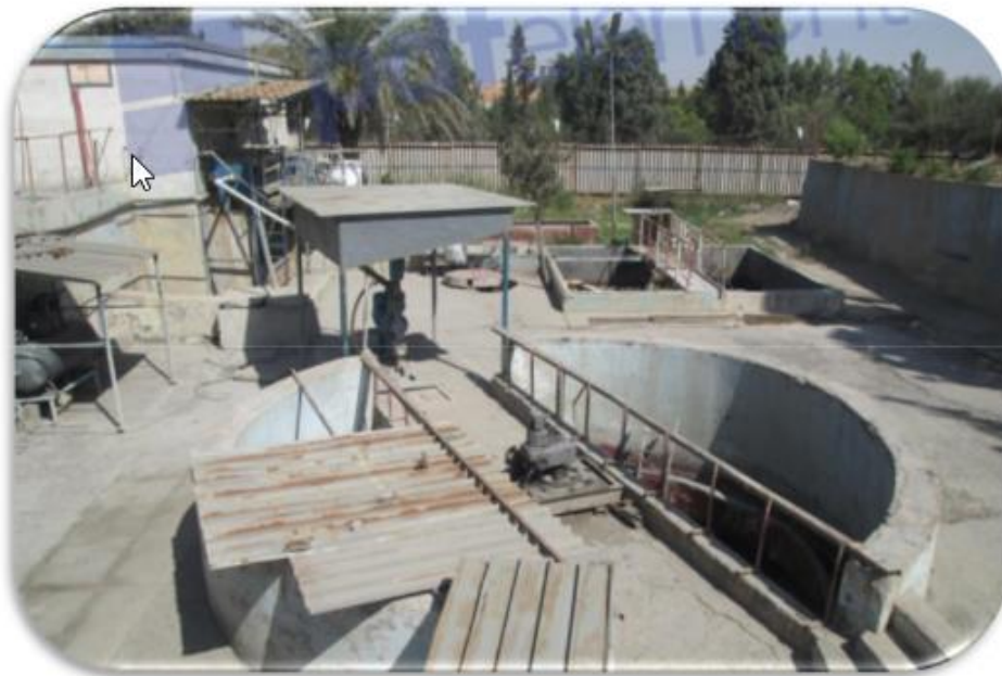
Figure I.11: Station de traitement des effluents liquides de l'unité.
