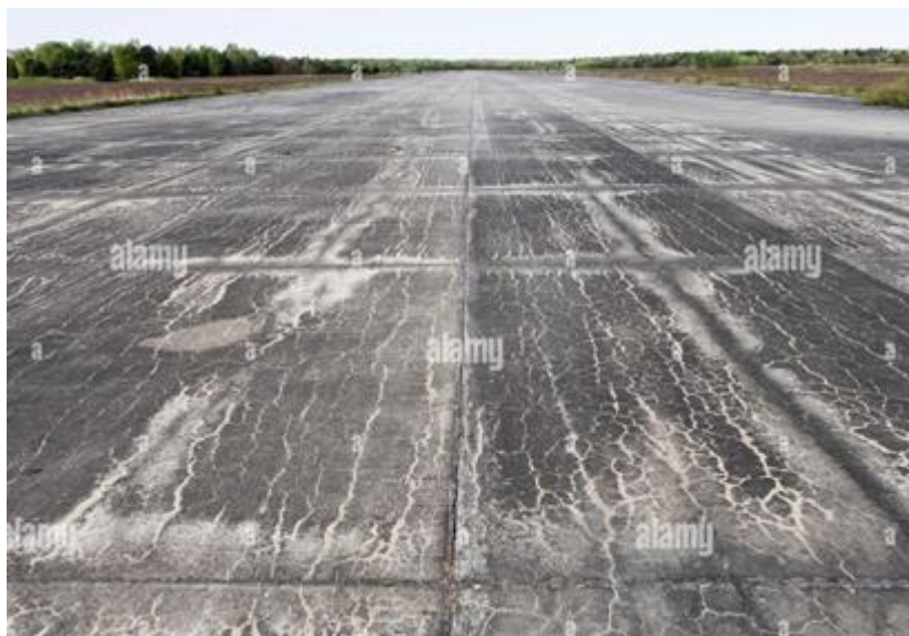
Figure 1 : Piste d'aéroport de béton abandonné [4]
