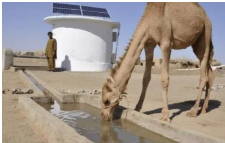
Figure 2-6 Système de pompage solaire approvisionnant un abreuvoir pour animaux.
