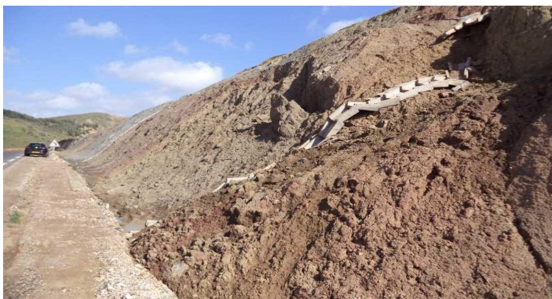
Figure I.08 : Désordre sur la couche 1 (Marni Sandid Iheb, 2014)
