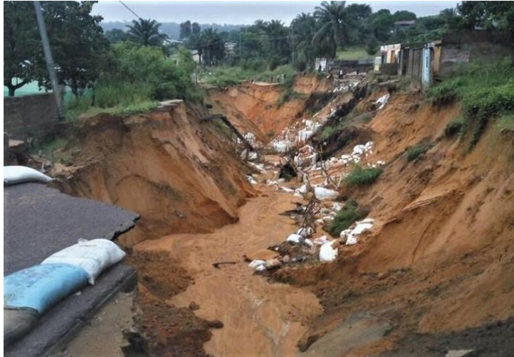
Figure II.17: Un glissement de terrain causé par la présence d'érosion (H, Zakaria et D, Mohamed., 2019)
