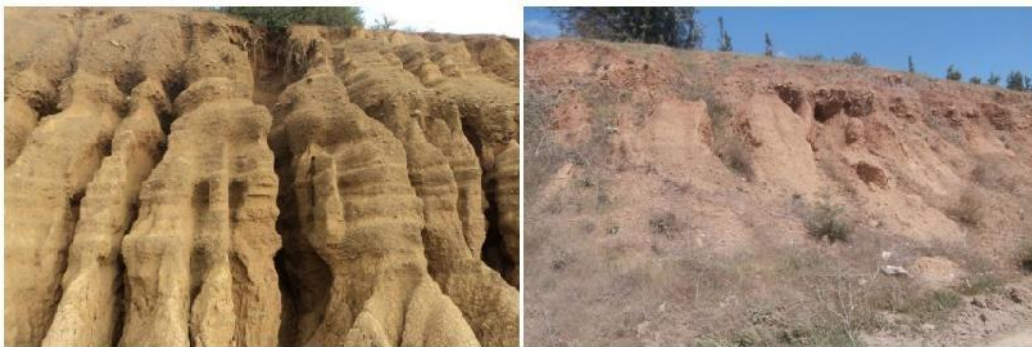
Figure II.40: Exemple de talus de déblai dans des sols de la matrice meuble érodés – CW Boukerdane TIPAZA (Durville, J. Gilles, S. 2000).
