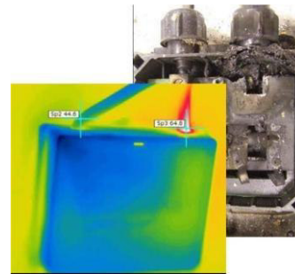
(b) corrosion dans la boîte de jonction
