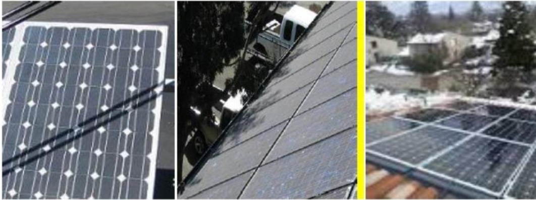
Figure I.15 : Défaut d'ombrage partiel.
