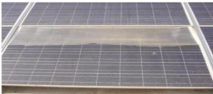
Figure I.9: Défaut de délaminage.
