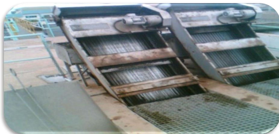
Figure 6 : Dégrillage (Station de Bordj Bou Arreridj).
