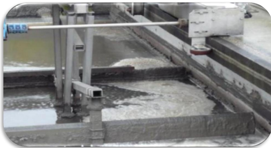
Figure 7 : Dessablage-Déshuilage (Station de Bordj Bou Arreridj).
