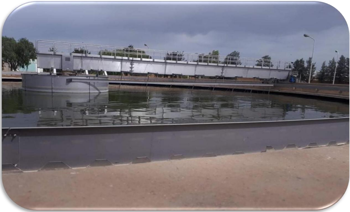
Figure 10 : Décanteur primaire (STEP BBA).
