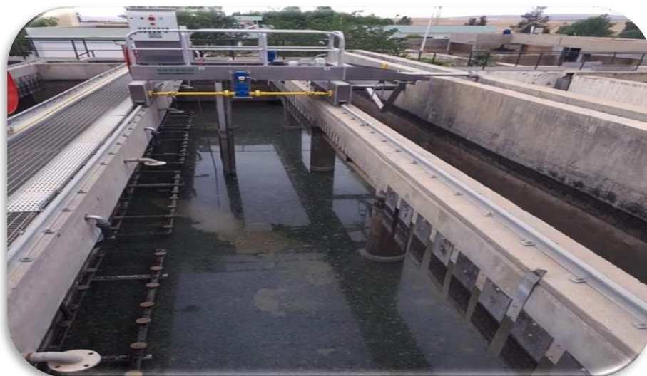
Figure 08 : Déshuileur et dégraisseur (STEP BBA)
