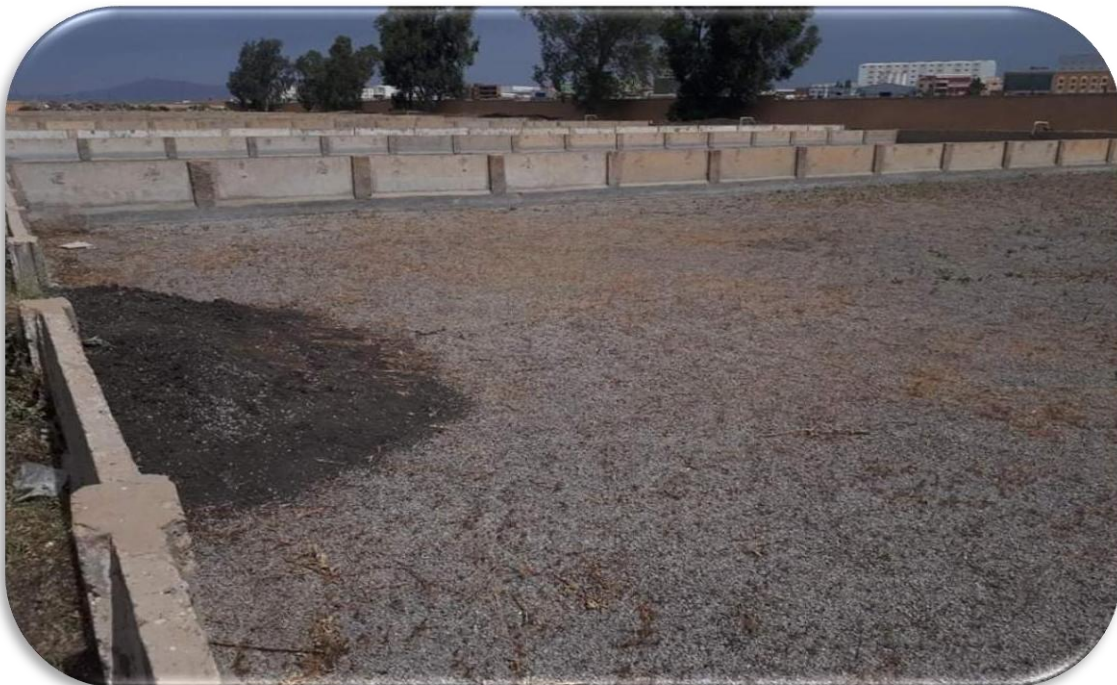
Figure 14 : Air de stockage des boues déshydratées ( STEP BBA )
