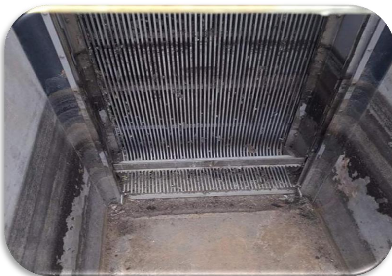
Figure 07 : Dégrilleurs (STEP BBA)
