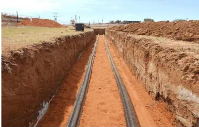
Figure 1.6 Câble électrique souterrain
