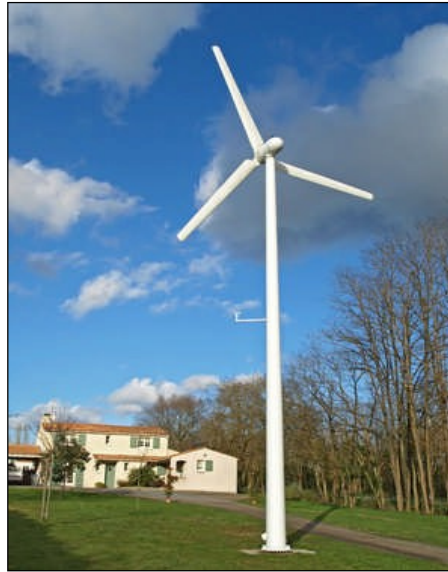
FIGURE 1.7 – Eoliennes à axe horizontal
