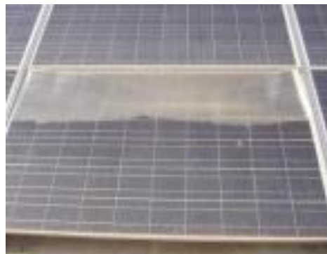
Figure I. 5 Défaut de Délaminage.[6]
